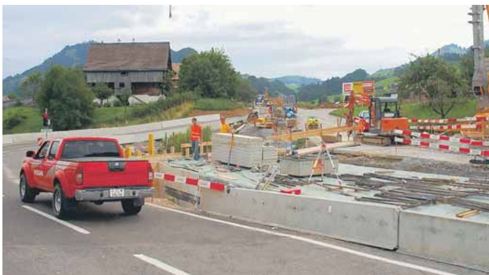
Baustelle bei Sattel: Die Sanierung stoppt 130 Meter vor dem Bahnübergang. Damit hält man sich beide Optionen offen, denn noch ist nicht entschieden, ob die Geleise künftig unterfahren werden.
